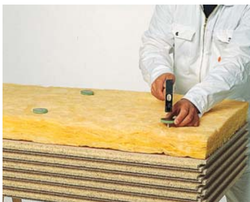
Hangelnyelő anyag a lábak felett
